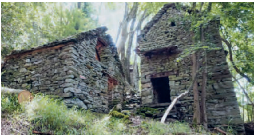
Ehemaliges Maiensäss Brancadello di sopra bei Cugnasco. Das Maiensäss wurde um 1960 aufgegeben, seine Bauten zerfallen. Der Heustall links im Bild gehörte um 1850/60 Carlo Giulieri (1807–1879). Fotografiert im Sommer 2023.
